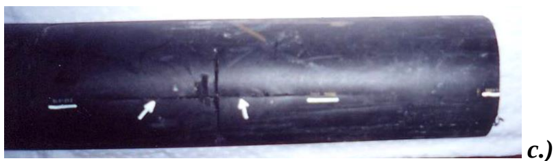
2.2.2.8 ábra: PE csővezeték hibák ivóvíz csöveknél
